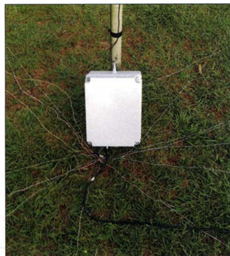
Radialnetz und Abstimmbox der Vertikalantenne für 160 m
